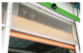
最新式レーザーセンサーで鉄壁の安全対策！
